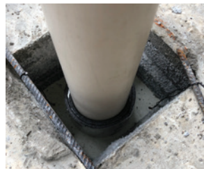
Fita intumescente instalada.
